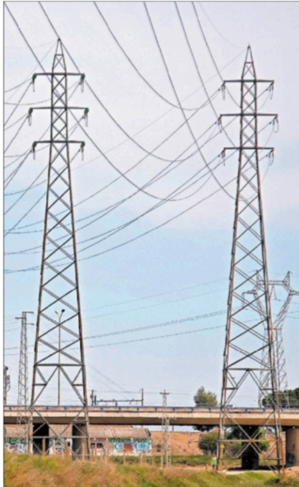
Tendido eléctrico a las afueras de Sevilla. / PACO PUENTES
